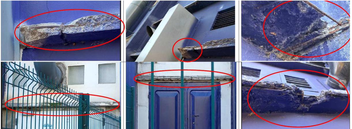
Maçonnerie (désordre n°70 page 17/43 du rapport de BVS)
