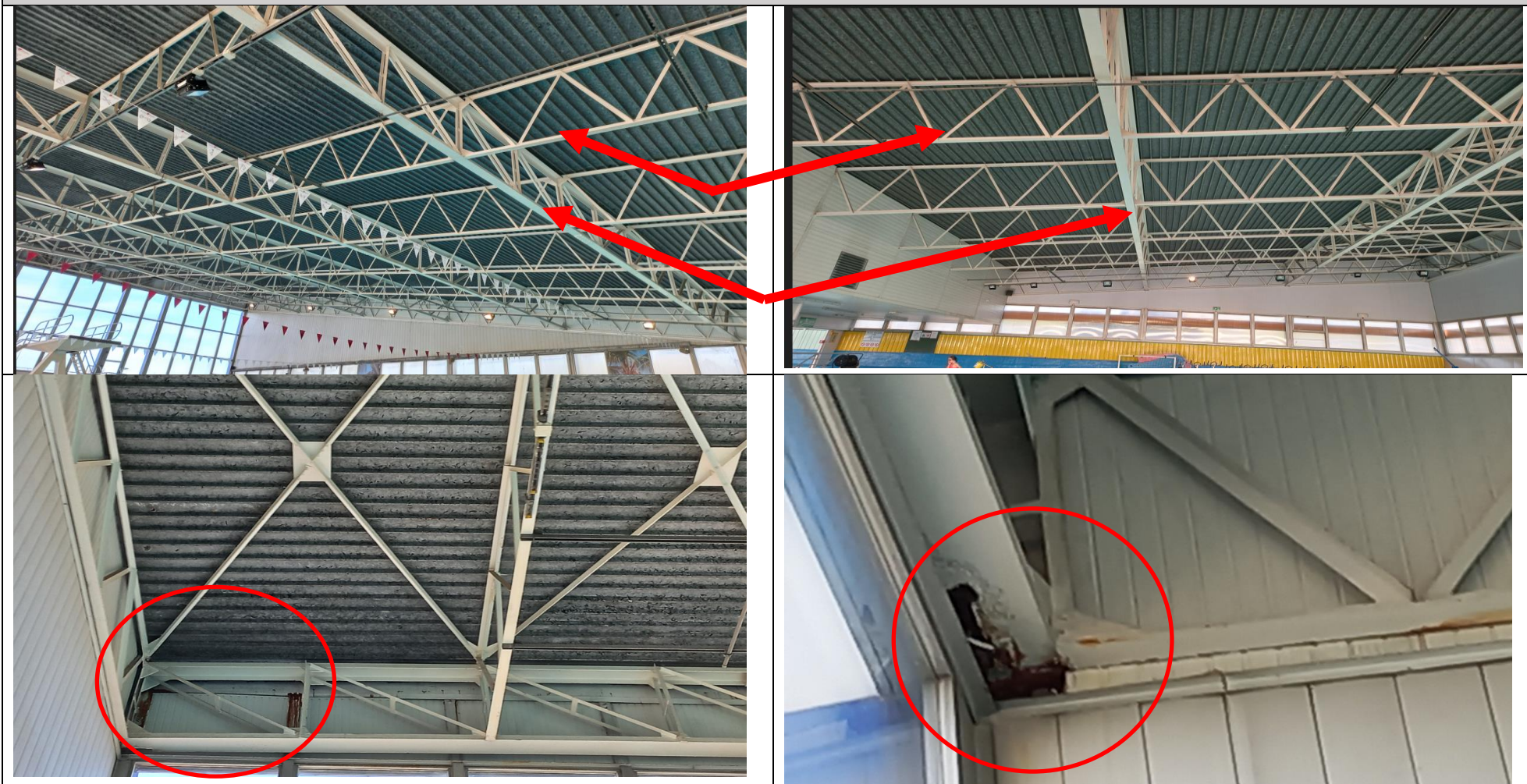
Photos – Désordres – Charpente métallique
