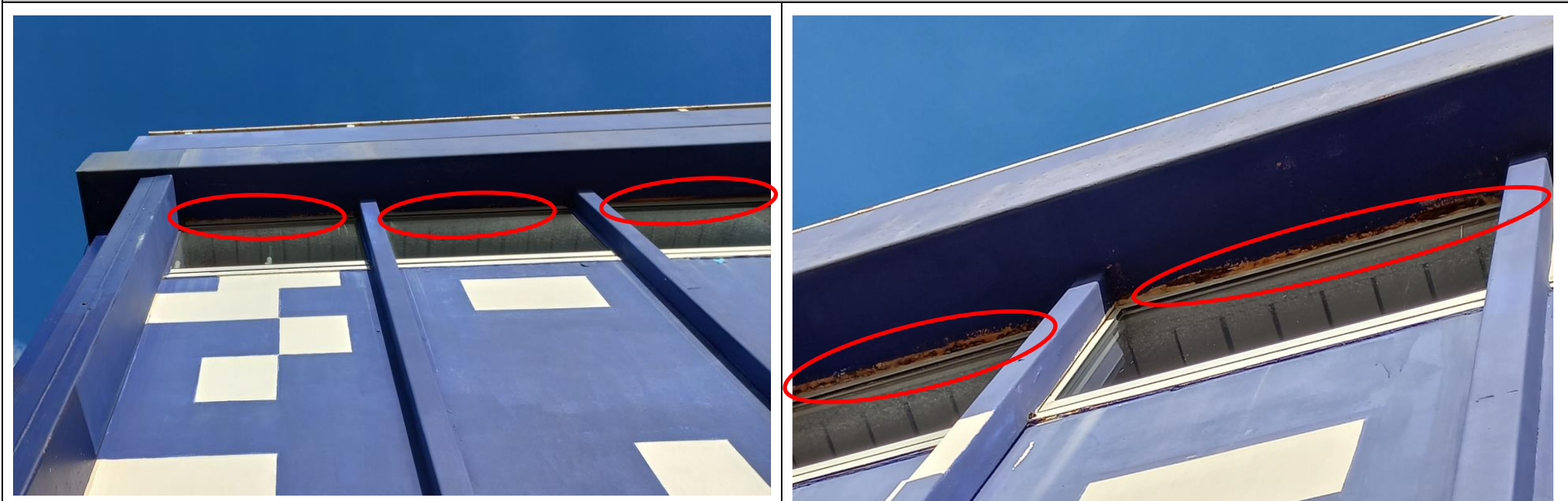
Photos – Désordres – Poutres métalliques en façades
